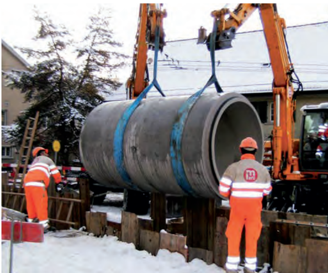
Entlastungsleitung vom Trennbauwerk zum Mattenbach
