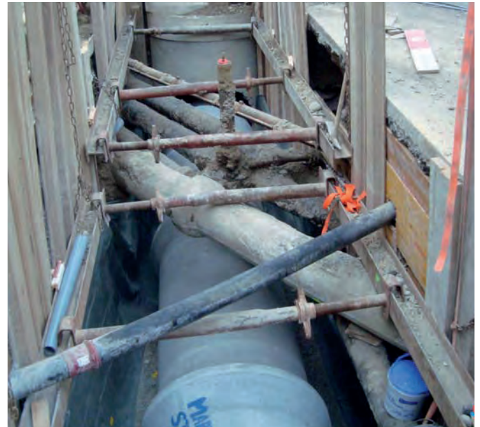
Katzensteigbach: Behinderungen durch bestehende Werkleitungen
