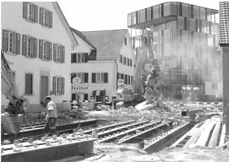
Die «Zollhausbrücke» von 1948 ist altersschwach geworden.
