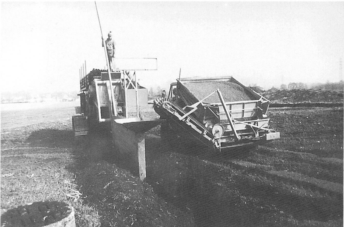
Moderne Maschine, die einen Graben öffnet und gleichzeitig die Drainage- rohre einlegt.
