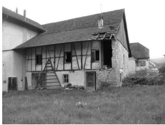
Dem Zerfall überlassen: Nebengebäude „Rösli“
