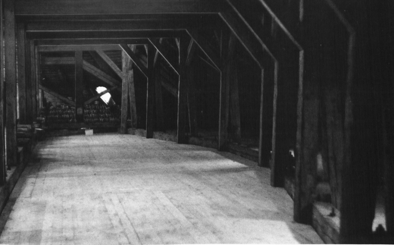
Der Dachstock lässt deutlich die Konstruktionsweise erkennen, wie sie von den grossen Brückenbauern jener Zeit angewendet wurde.
