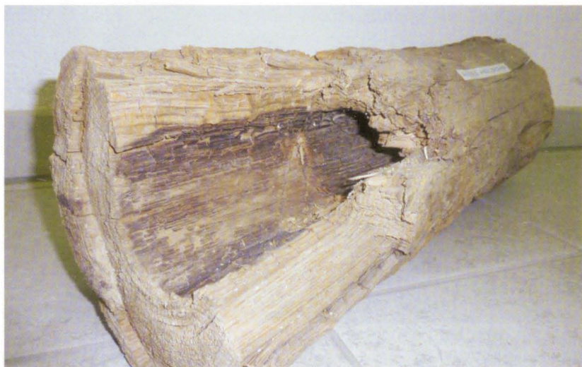
Dieses Holzrohr wurde vor etwa 25 Jahren entdeckt und ersetzt, als die Wasserversorgung in Gutenswil neu gebaut wurde. (Bild: Esther Wolff)
