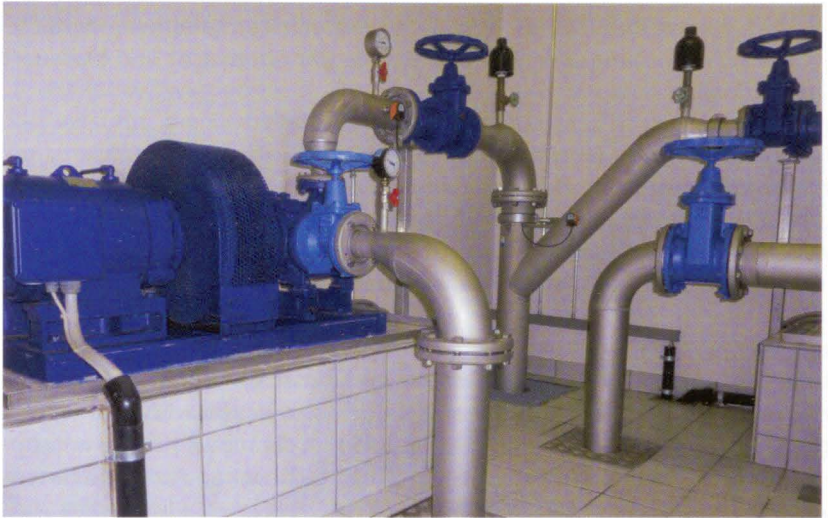
So sieht ein Pumpwerk von innen aus: Pumpen, Rohre und Schieber. (Bild: Esther Wolff)
