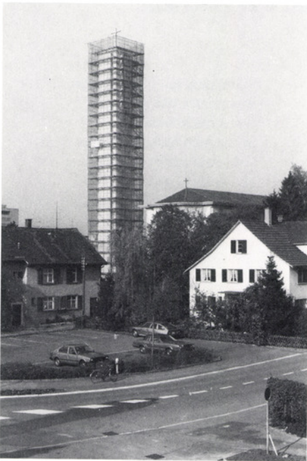
Ungewohnte Ansicht der katholischen Kirche: Der Turm erhält im Herbst 1983 einen neuen Anstrich.
