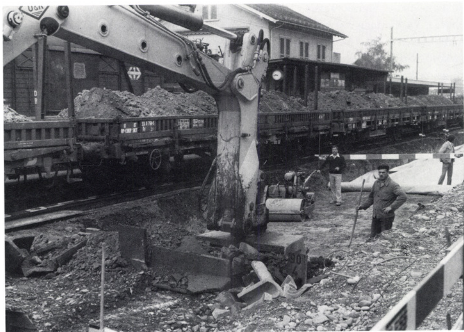
Auch die Vorbereitung des Trassees für die Neuverlegung von Stationsgeleise 3 erheischte umfangreiche Erdarbeiten.
