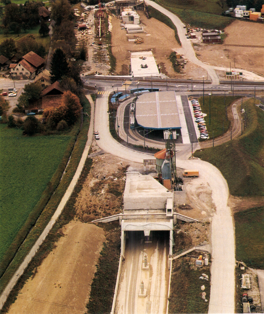
Das Gebiet der Station Stettbach im Oktober 1986. Am oberen Bildrand der Eingang zum Zürichberg-Tunnel, darunter das im Tagbau erstellte und teilweise schon wieder überdeckte unterirdische Zwischenstück bis zur Bahnhofshalle Stettbach. Ob darüber eine Park-and-Ride-Anlage entstehen soll, war im Herbst 1987 noch umstritten. In der Bildmitte die Tram- und Bus-Schleife «Bahnhof Stettbach». Links neben dem Sagentobelbach und oberhalb der Zürichstrasse das inzwischen verschwundene alte Bauerngehöft.
