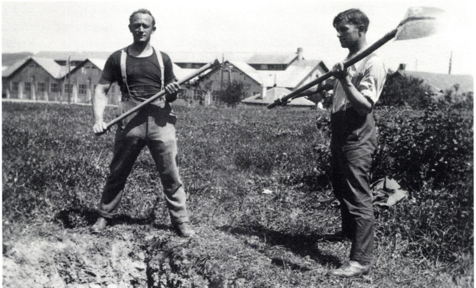
Die Freiwilligen Walter Wüthrich und Ernst Häberli 1928 bei Instandstellungs- und Anpassungsarbeiten an der Handgranatenanlage Soldatenstube.
