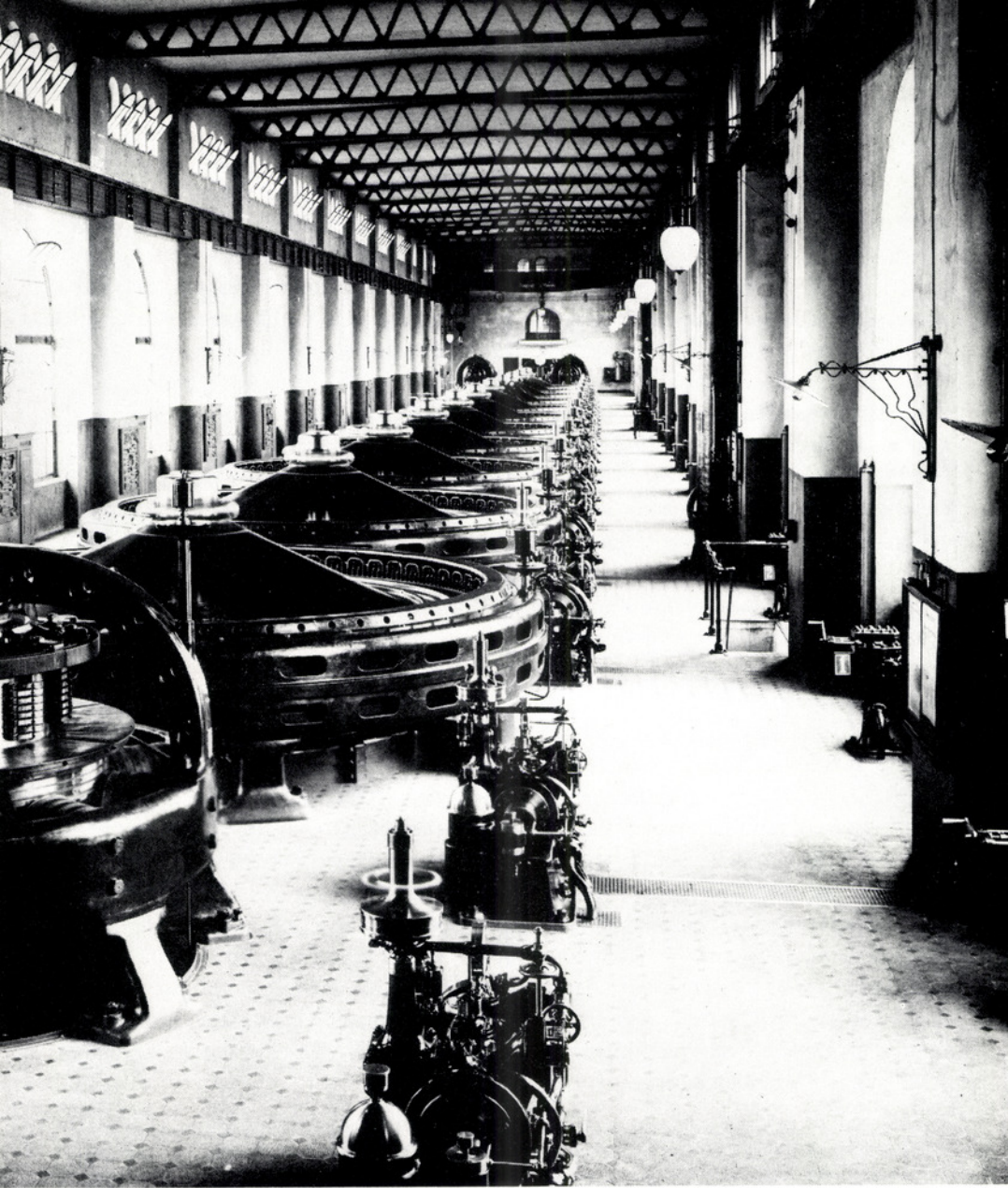
Blick in den Maschinensaal des 1902 von der A.G. Motor in Betrieb genommenen Kraftwerkes Beznau an der Aare, aus welchem Dübendorf den ersten elektrischen Strom bezog. Das Werk verfügte 1904 mit elf Maschinengruppen über eine Leistung von 14000 PS.
