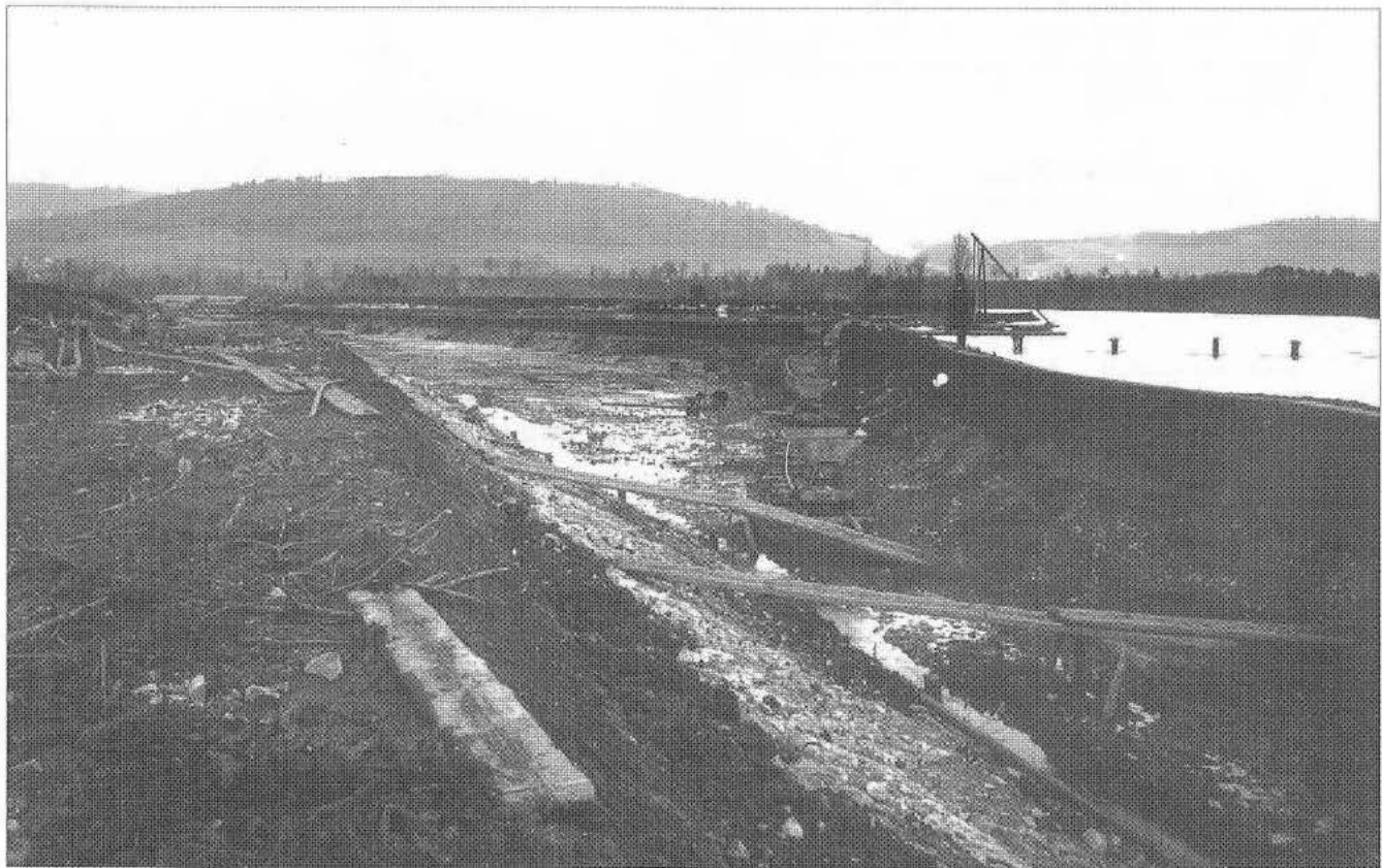
Nur die vollständige Schliessung des Klappenwehrs machte den Ausbau und die Neugestaltung des Fabrikkanals zu den Webereien und dem späteren Elektrizitätswerk möglich. Erstaunlich, dass die weitgehend abgetragene rechtsseitige Kanalmauer entlang der Limmat den Wassermassen des Flusses ohne Spundwände standzuhalten vermochte.
