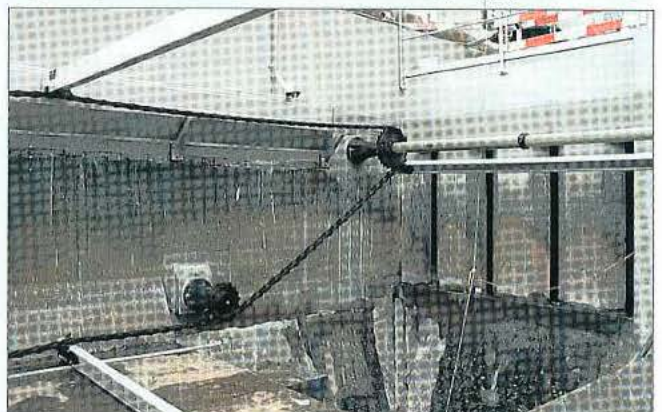
Der Räumler schleppt den Sand über den Beckenboden zum Sammeltrichter. Zur Wiederverwendung wird der Sand von Fremdkörpern gereinigt und gewaschen.
