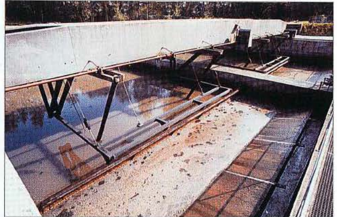
Weil Fett schwimmt, kann es von der Wasseroberfläche abgestreift und der Schlammverbrennung zugeführt werden.
