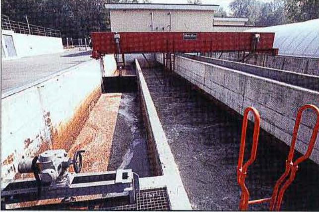
Zuerst fliesst das Schmutzwasser durch den Sandfang (rechts im Bild), anschliessend durch den Fettfang (links)
