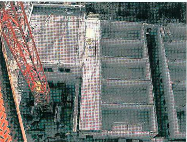
Blick vom Kran auf das oberste Stockwerk des 12,5m hohen Filterhauses vor der Überdachung. Die Filterkammern fassen insgesamt 8000 m 3 .
