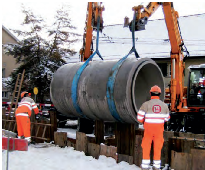
Entlastungsleitung vom Trennbauwerk zum Mattenbach
