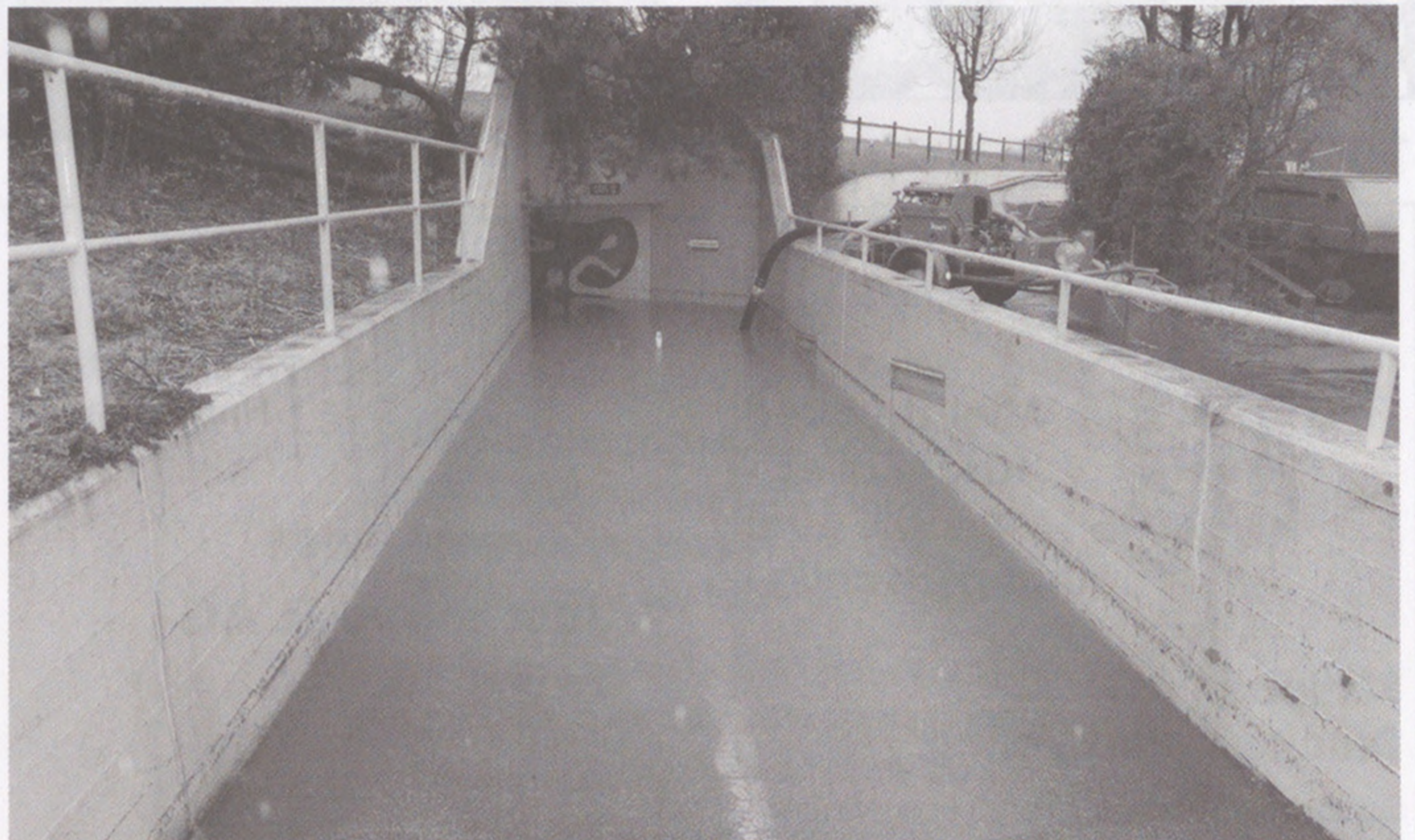
Die Unterführung zum Loorenschulhaus musste ebenfalls ausgepumpt werden. (Foto: sl)
