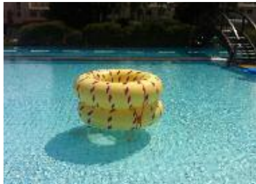
Behelfsmässig mussten Schwimmringe über den Schadstellen platziert werden.
