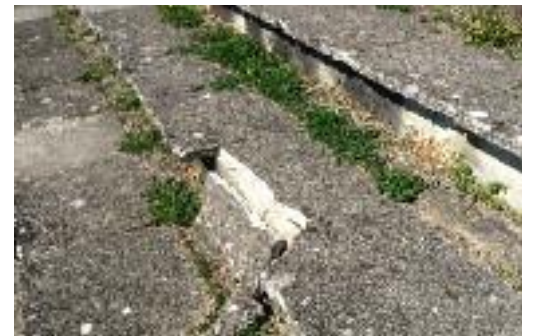
Eine Sanierung der Tribüne der Spielwiese Bachwis war unumgänglich.
