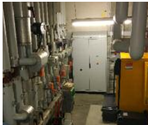
Neue Heizungsanlage im Oberstufenschulhaus in Grafstal.
