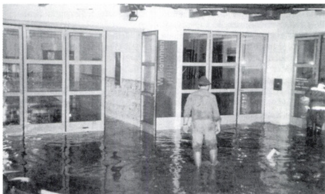
Garage Karlen, Eggstrasse. Der Wasserhöchststand ist an der Wand abzulesen.
