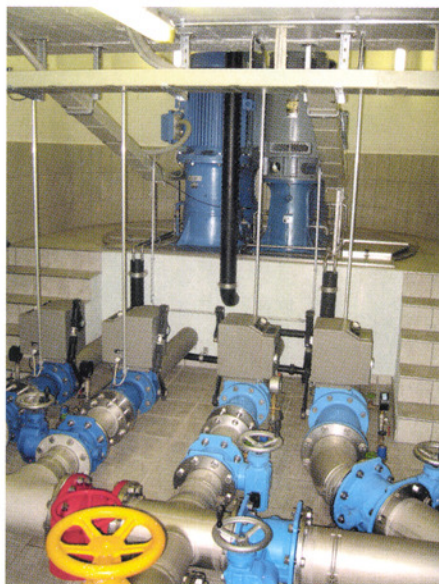
Blick in den Pumpenraum. Energie Uster AG
