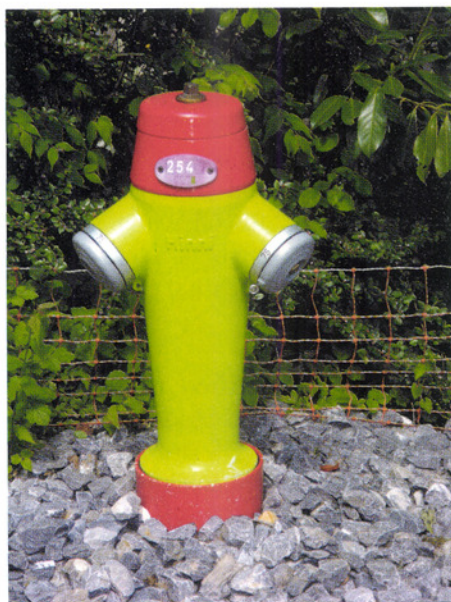
Hydrant Hinni – Im Brünneli in Aesch.
