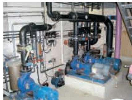
Badewasseraufbereitung - Dringender Modernisierungsbedarf
