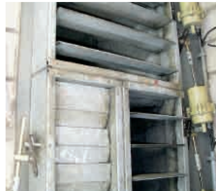
Lüftung - Veralterte pneumatische Steuerung
