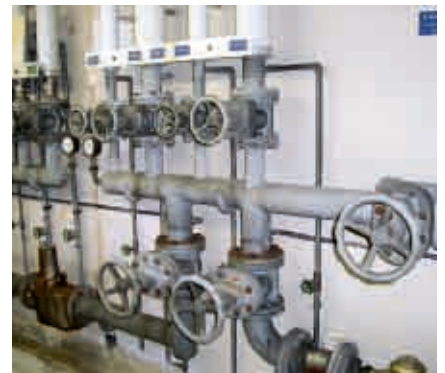
Sanitäranlagen - Wirkung von Salzsäure und Chlor
