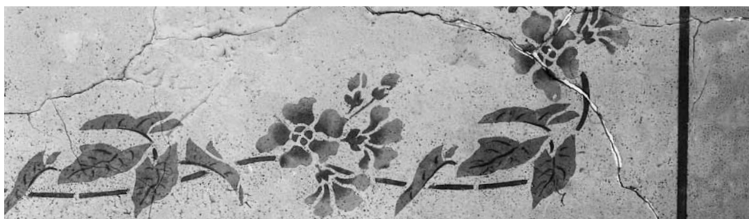
Schablonenmalerei an einer Decke im 1. Obergeschoss, Zustand 1995.
