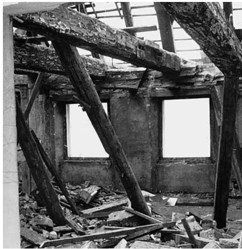
Die originale Bausubstanz samt Dachstuhl wurde zum grössten Teil zerstört. Zustand 1996.
