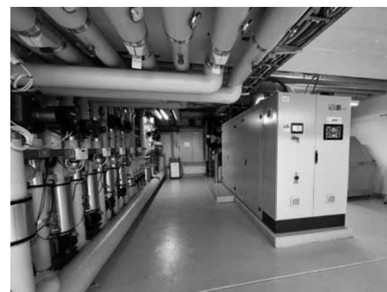
Technikzentrale mit der Hybridbox mit 240 kw/h.
