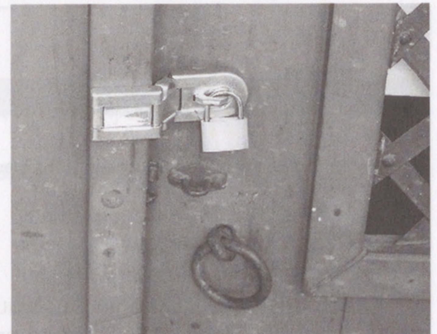
... auch hier: Ungenügende Sicherung einer Kellertüre
