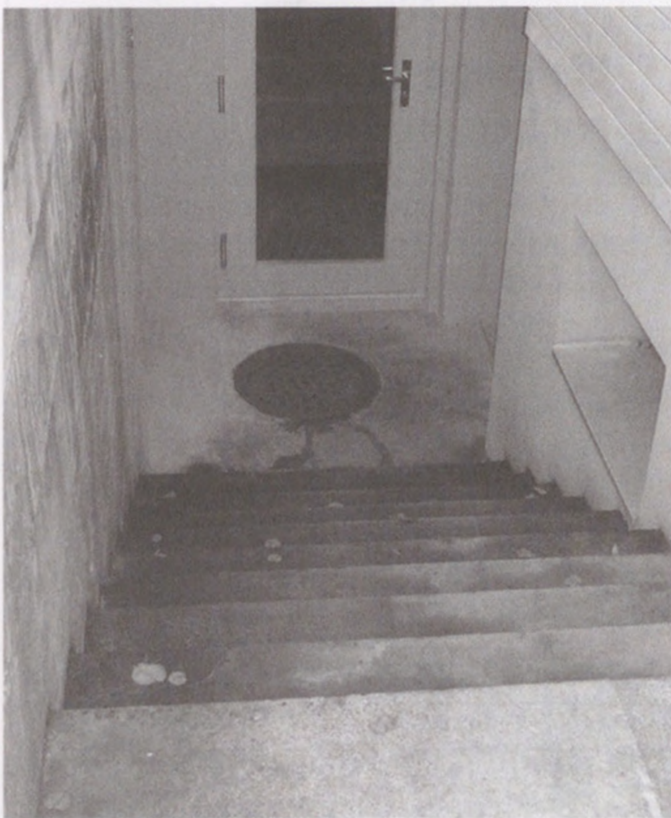
Sehr beliebt bei Einbrechern: Kellereingangstüren.
