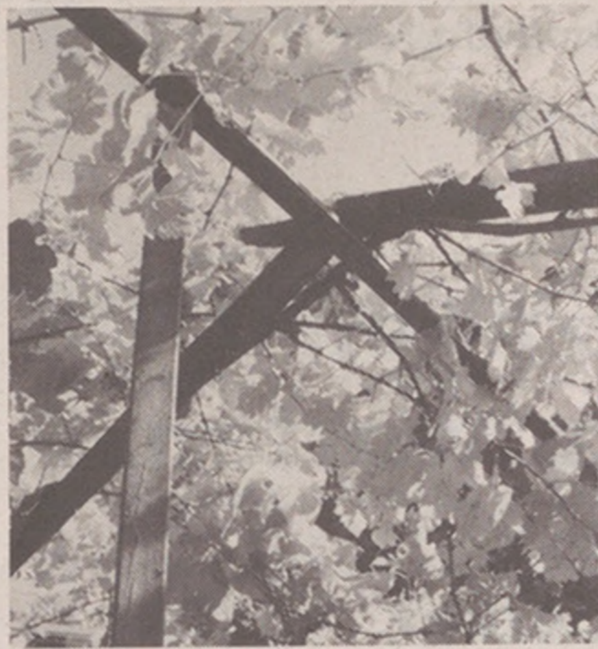
Alle Querträger der Pergola geknickt
