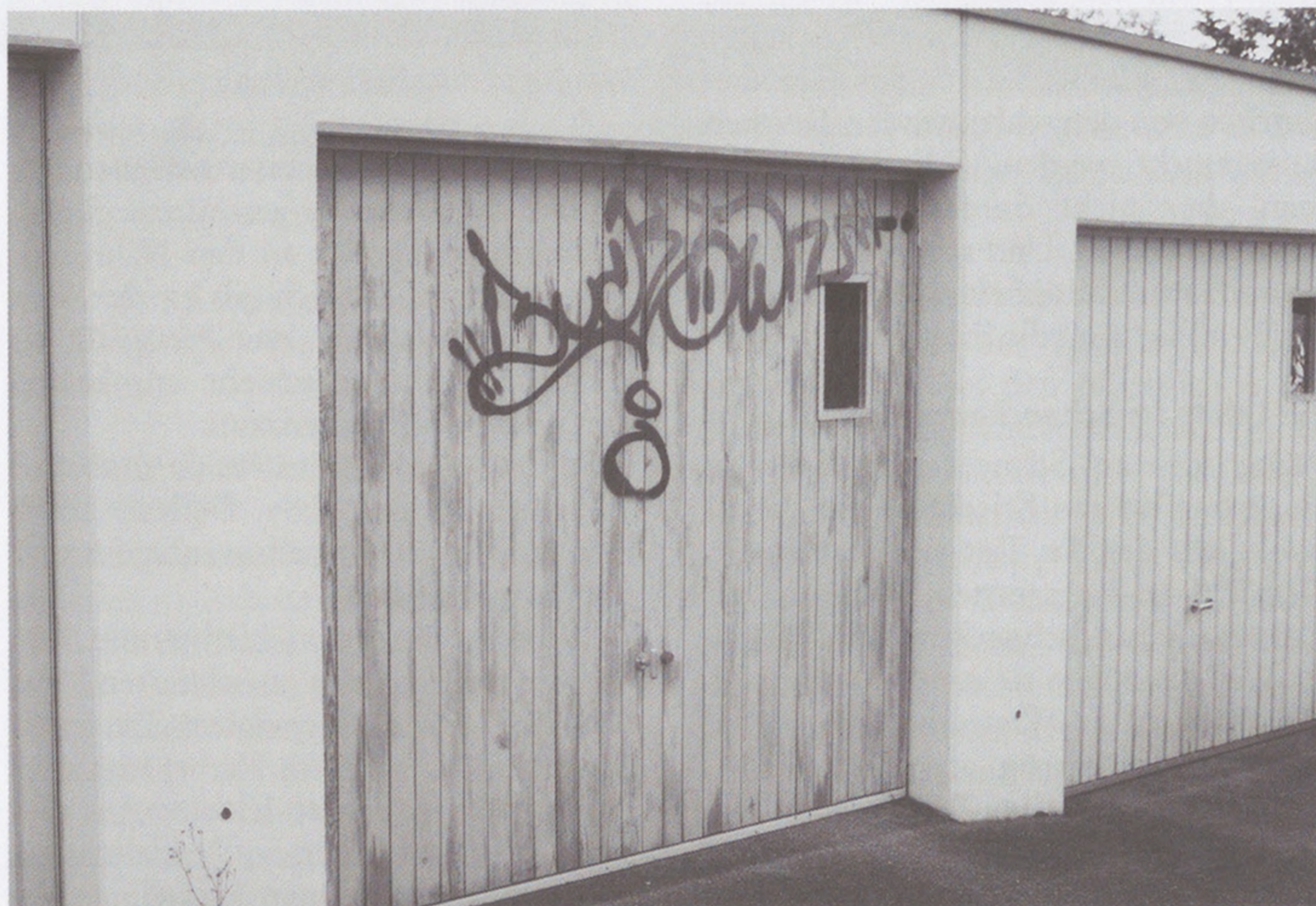
Sinnlose Sprayereien, wie hier an der Bachtelstrasse in Ebmingen, nehmen wieder zu. (Foto: fri)
