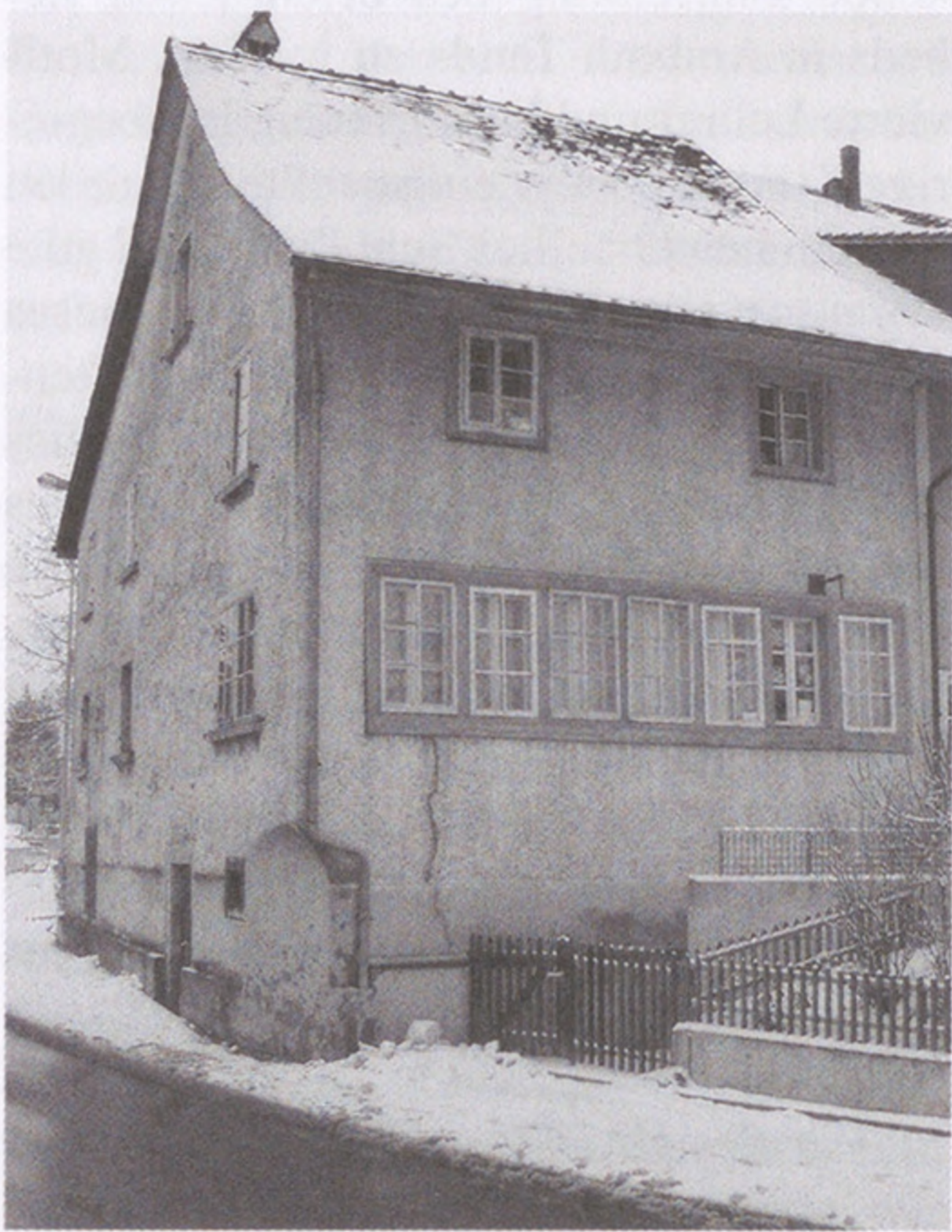
Das Haus an der Zürichstrasse 216 in Binz ist sanierungsbedürftig. Ein Neubau erscheint sinnvoller. (Foto: zvg)
