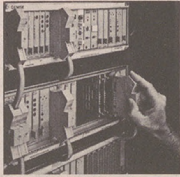
⑦ Fernwirktechnik Installation de télécommande ALBIS tc 3-20
