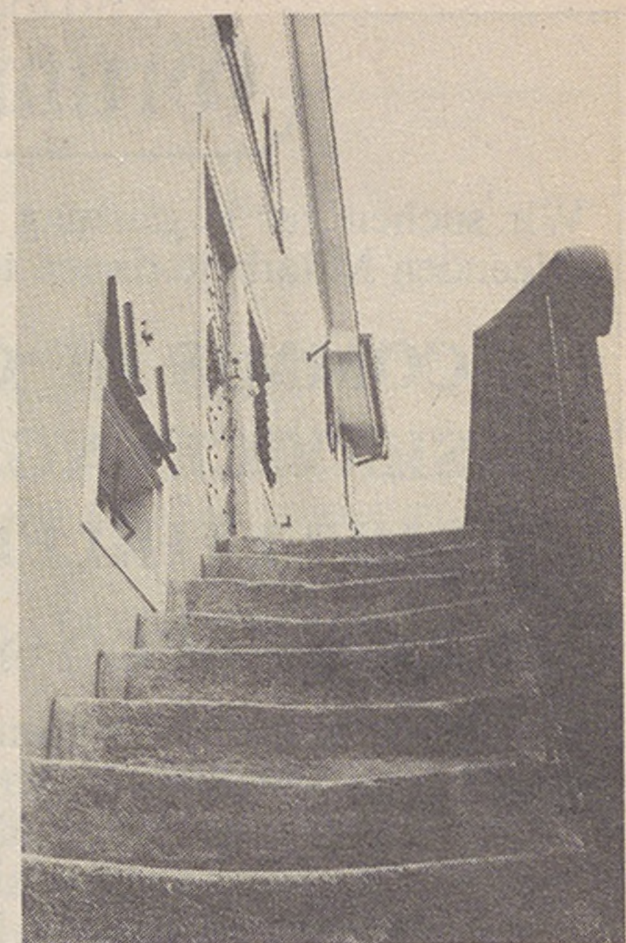
Die Treppe wurde in der zweiten Bauphase, vermutlich zirka um 1740/50 angebaut... Generationen hinterliessen ihre Spuren im eher weichen Muschelkalk.
