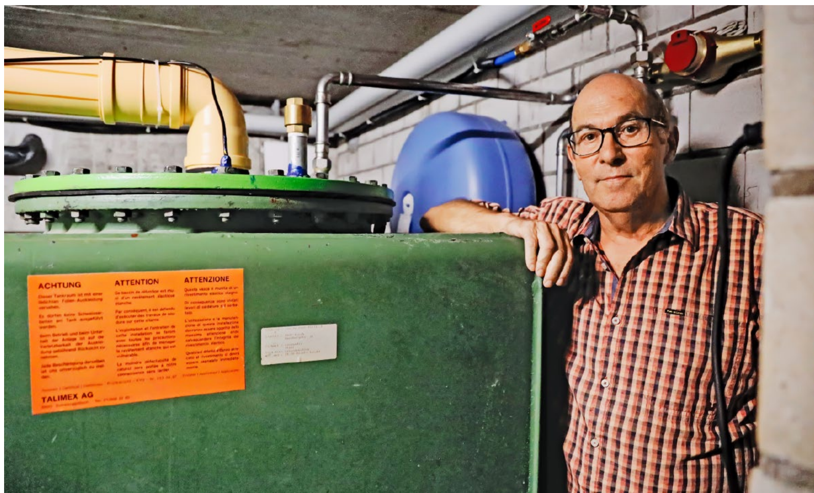
Alfio Zweifel wässert seinen Garten mit Regenwasser. Dieses speichert er im Keller im umgebauten Heizöltank.
