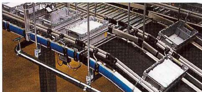
Die Anlagen verarbeiten Briefbehälter nach posteigener Norm. Diese messen 50 x 29 x 22 cm und wiegen max. 15 kg.
