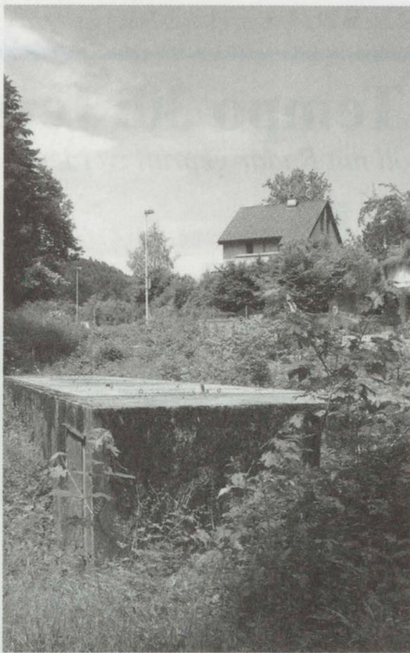
Der überwucherte Betonkasten des Regenklärbeckens Aesch. (Fotos: Markus Gossweiler)
