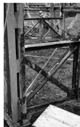
Die Profile der Querträger vor den Widerlagern sind teilweise vollständig durchgerostet. Zustand nach dem Abbau der Fahrbahn, Dezember 2011. KDP Fotoarchiv.
