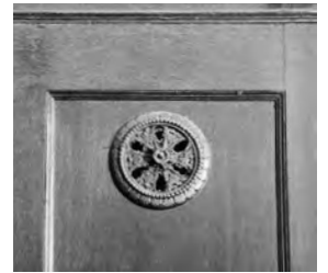
Gusseiserne Rosette als Abdeckung der Luftheizung im Erdgeschoss. Zustand September 1989. KDP Fotoarchiv.
