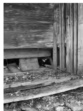
Ausschnitt einer Blockwandung über einem Stützel. Zustand vor der Instandstellung, April 2010. KDP Fotoarchiv.
