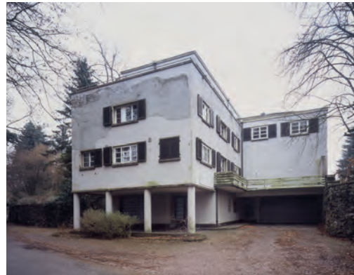
Links: Ansicht von Südwesten mit der 1982 verglasten Veranda. Rechts: Ansicht von Nordwesten mit den deutlich erkennbaren Schäden, die durch das Schwimmbad im 2. Obergeschoss verursacht worden sind. Zustand vor der Renovation, März 2011. KDP Fotoarchiv.
