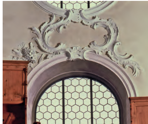
Stuckkartuschen über Rundbogenfenstern im Bereich der Südwest- bzw. Südostempore. Zustand vor der Restaurierung, Januar 2011. KDP Fotoarchiv.
