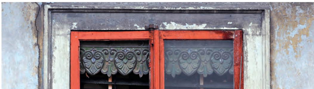
Zierbleche über den Roll- läden. Zustand vor der Renovation, Juli 2010. Dok. 17, S. 40.
