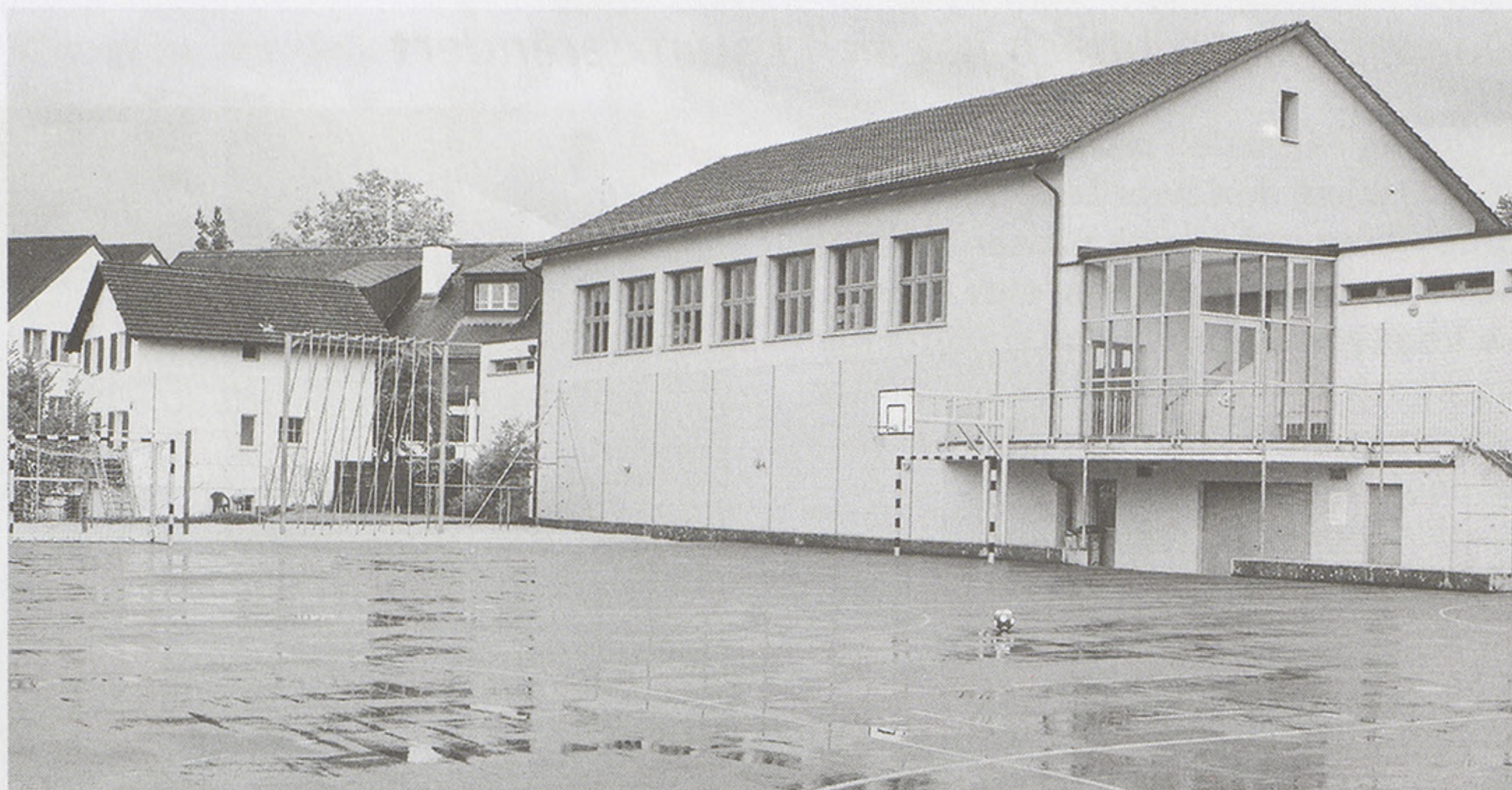
Der rote Platz beim Schulhaus Pünt in Maur ist sanierungsbedürftig.
