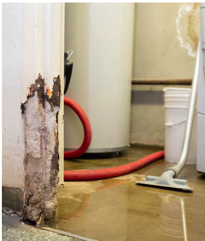
Private Liegenschaften sind von der Hochwasserproblematik betroffen
