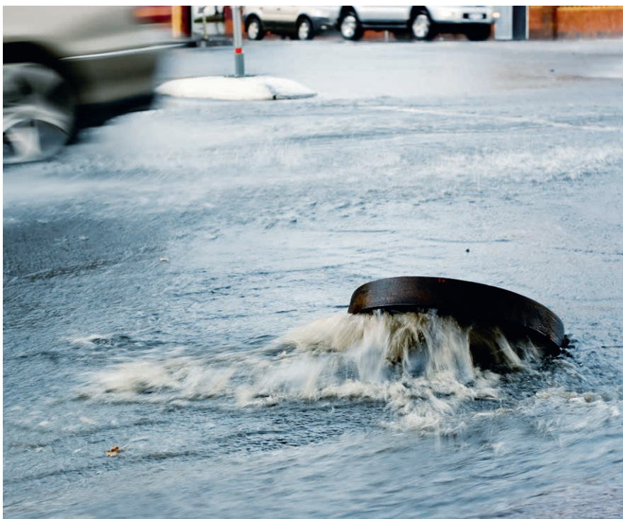
Gelöste Schachtabdeckungen können Personen- oder Sachschäden verursachen
