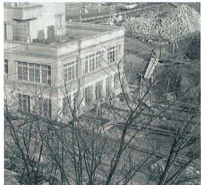
Mit hydraulischen Pressen wurde das Gebäude angehoben und dann über Stahlschienen langsam, Centimeter für Centimeter, an den neuen Standort geschoben.
