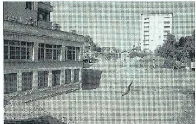
Dann wurde am neuen Standort ein neues Fundament gelegt und die Bahn für die «Reise» frei gemacht.
