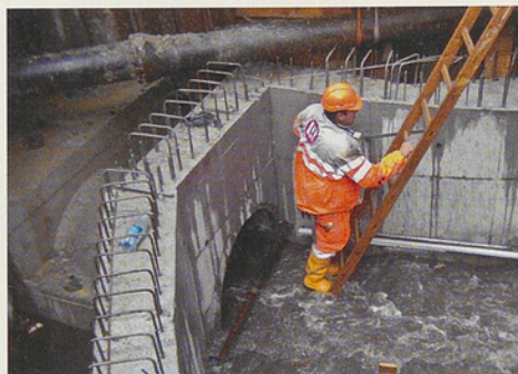
Trennbauwerk bei starkem Regenfall
