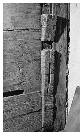
Verstrickung Aussenwand/Innenwand an der Südwestseite. Zustand 1992.
