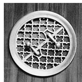
Vergitterte Einstellklappe aus Messingguss der Warmluftzentralheizung im Südostzimmer im 1. Obergeschoss. Mit einem einfachen Gleichgewichtsmechanismus konnte durch das Gitter der Warmluftfluss in den Raum dosiert werden. Zustand 1993.
