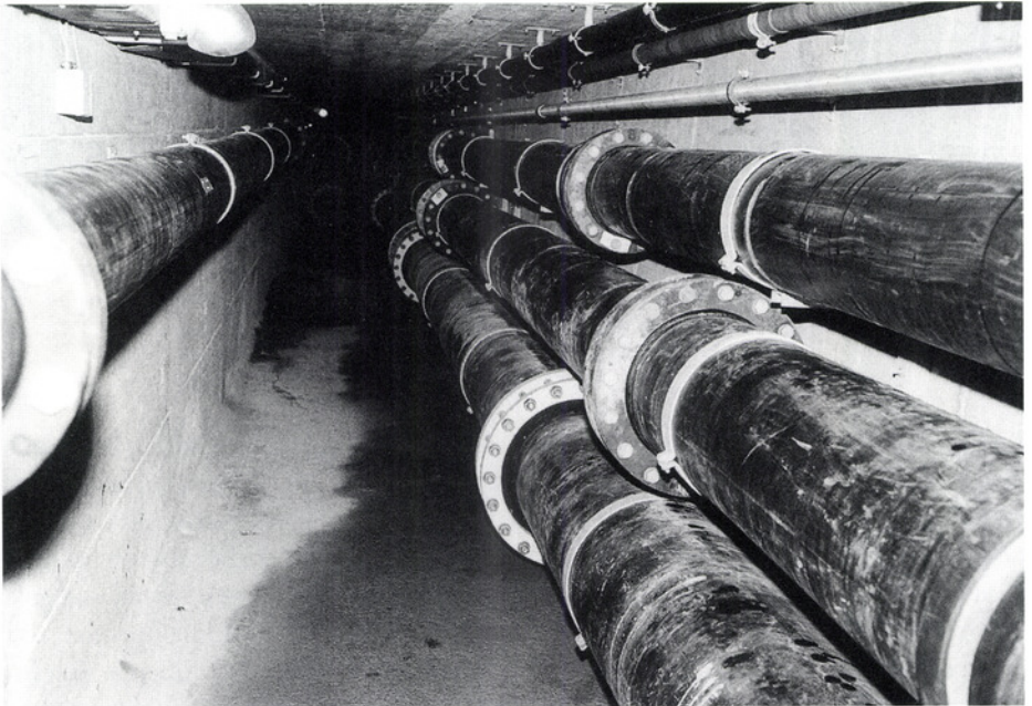
Die Rohre verlieren sich im Dunkel des schwach erleuchteten unterirdischen Gangs neben dem Schwimmerbecken.
