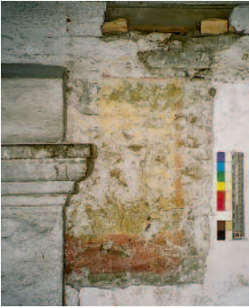
Aufgemalter Eckquader an der östlichen Ecke der Nordostfassade. Zustand während der Sondierung, Mai 2005. KDP Fotoarchiv.
