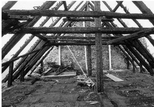
Links: Teilansicht des verkohlten Dachstuhls mit Blick gegen die westliche Giebelmauer. Zustand 16. August 2004. Rechts: Notdach und westliche Giebelmauer. Zustand Oktober 2004. KDP Fotoarchiv.
