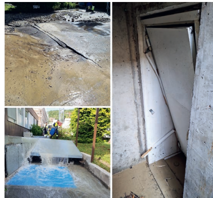
Wasserrohrbruch mit Eindringen von Wasser in Gebäude
