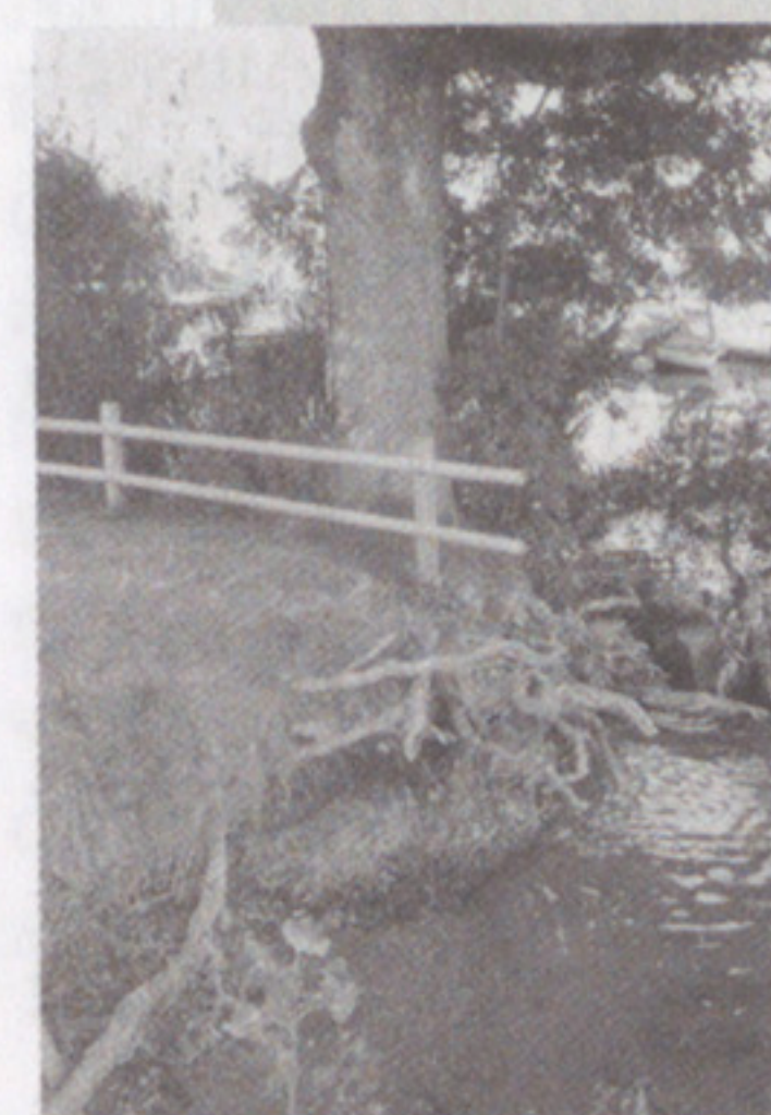
Seit der hohe Wasserstand sinkt, sieht man die Erosionsschäden.
