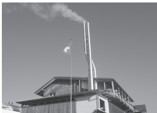
Wärmeerzeugungsanlage der Firma Heider
