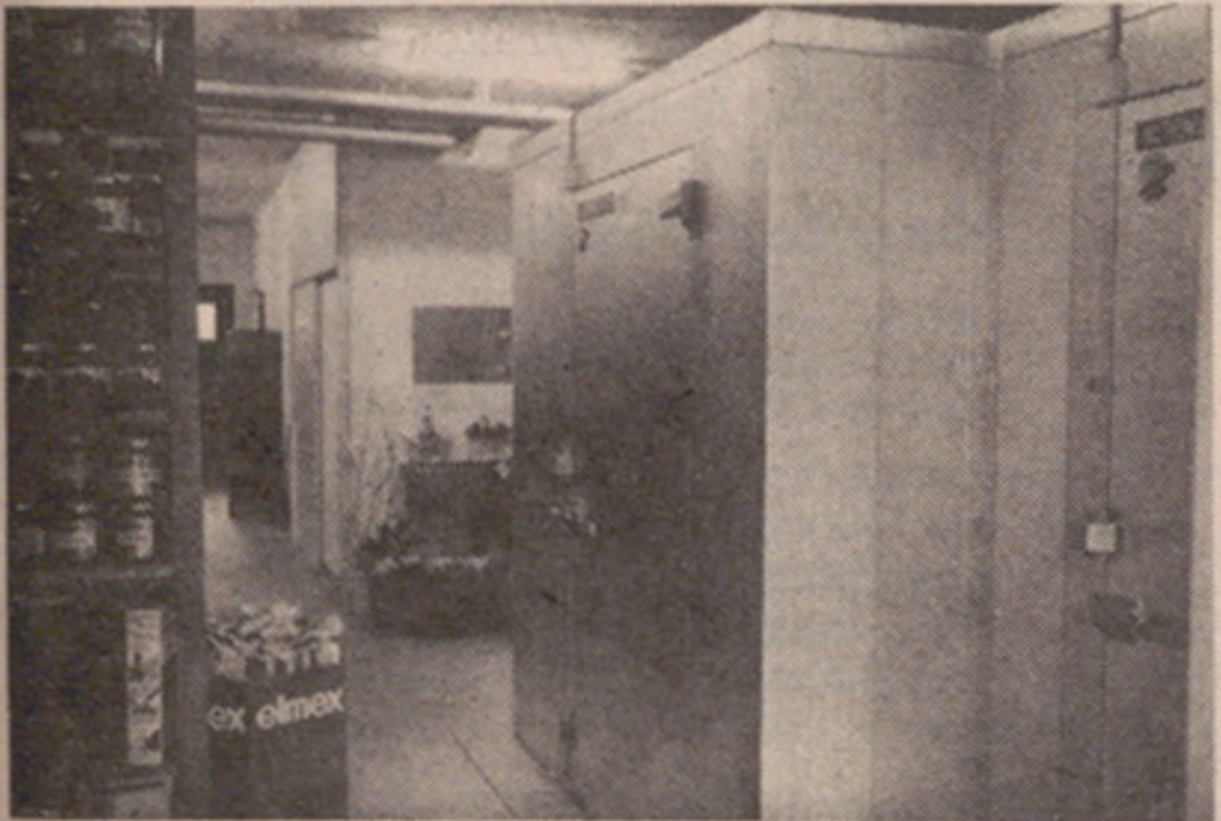
Grosse Kühlapparate sind erforderlich für die Frischhaltung der Lebensmittel. Kühlapparate produzieren Wärme — damit wird der gesamte Warmwasserbedarf bestritten. Die Heizung wird mit Gas betrieben, eine besonders umweltfreundliche Art zu Heizen, keine schädlichen Abgase.
