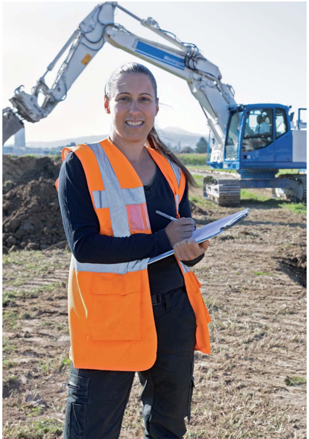
Die Leiterin des Teams Baubegleitung, Anna Kienholz, bei der Baustellendokumentation. Laufende Baggerarbeiten lassen nur ein kurzes Zeitfenster offen.
