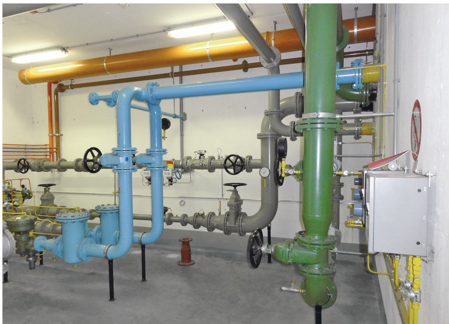
Leitungen im Innern der Gasübergabestelle DRM «Zürichstrasse». Blau: Hochdruckleitung von fünf bar; grau: Mitteldruckleitung von 700 mbar; grün Niederdruckleitung, die mit erhöhtem Niederdruck von 68 mbar in die Erschliessungsgebiete führt.
