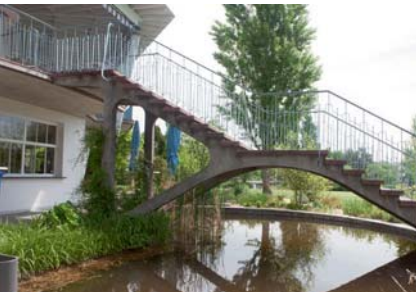
Restaurierungserfolg beim Restaurant: Die Eleganz der ursprünglichen Situation (oben) opferte man einer unterhaltsamen Lösung (Mitte). Glücklicherweise nur verfüllt, konnte das Bassin 2006 instand gestellt werden. (Foto oben: ETH Zürich, gta Archiv, Nachlass Gustav Ammann; Mitte: Grün Stadt Zürich)
