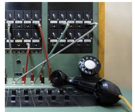
Telefonzentrale im Bunker.
