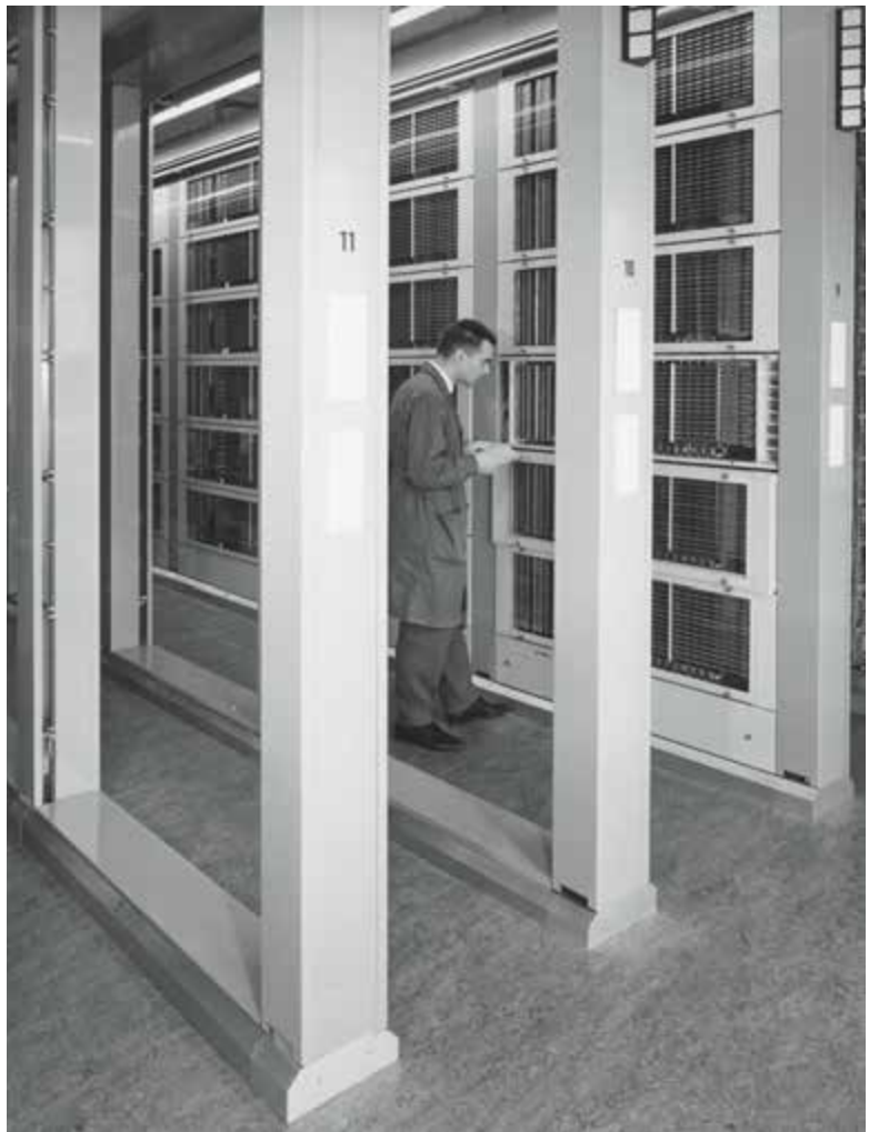
Betriebsmeister Rudolf Fuchs in der neuen Telefonzentrale an der Löwengasse 17, 1969.
