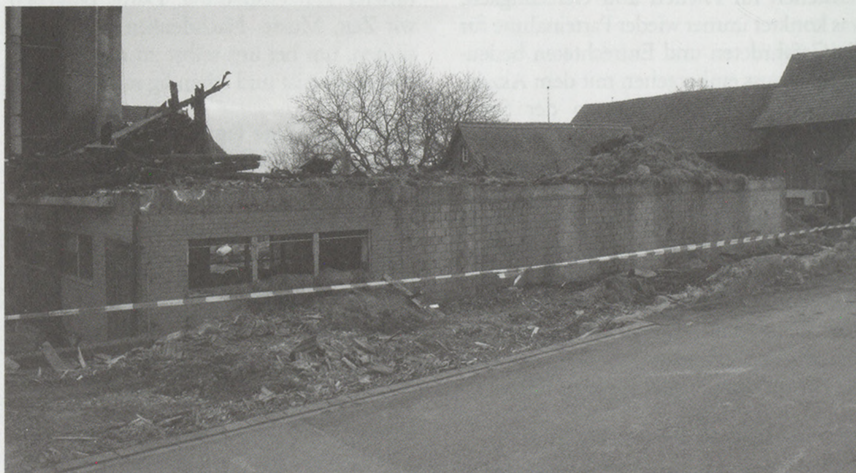
Nach dem Brand stehen nur noch die Grundmauern der alten Scheune.
