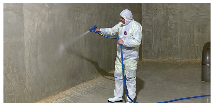
Das Reservoir Hofstetterweid bei der Besichtigung am Infoabend (oben) und bei der jährlichen Reinigung durch Brunnenmeister Stefan Gygax
