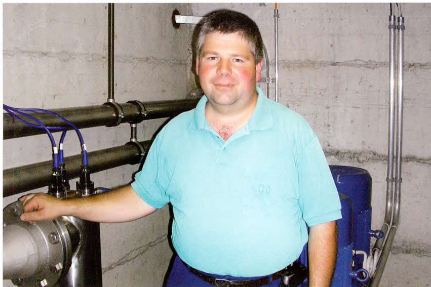
Brunnenmeister Bruno Brüngger betreut das Pumpwerk in Mesikon, welches der Wasserversorgungs-genossenschaft Horben-Mesikon gehört.
