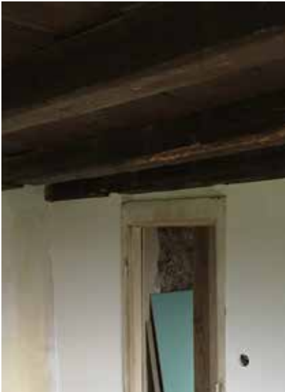
Zwei angesengte Balken vermutlich, vom Brand 1834 stammend.
