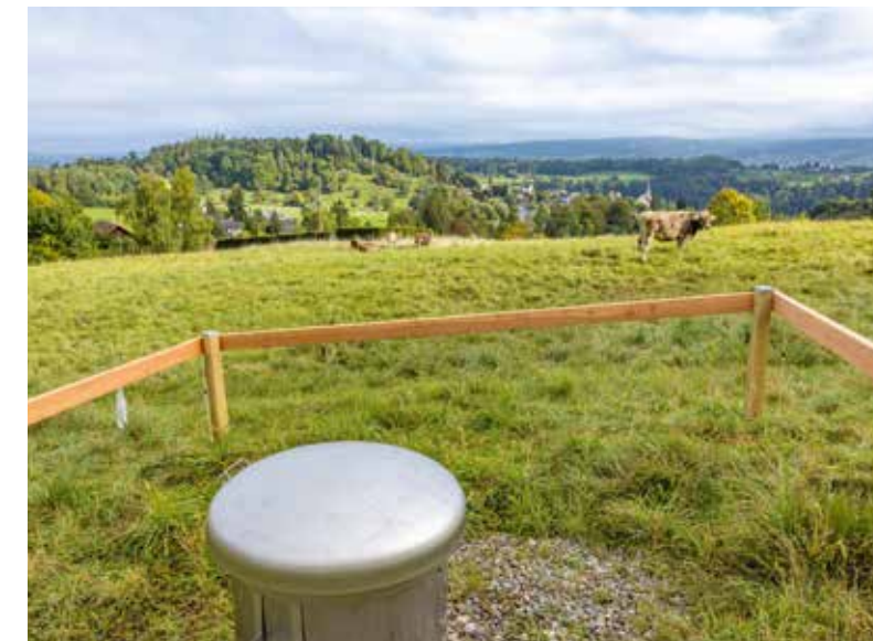
Umzäunte Quellfassung der Gemeinde Kilchberg im engsten Schutzgebiet auf der Schellerweid auf 610 Meter über Meer. Von hier fliesst das Wasser ins Sihlthal und überwindet auf der Gegenseite die Zimmerbergkette auf einer Höhe von 520 Meter ü. Meer. Fotografie, 2025.
